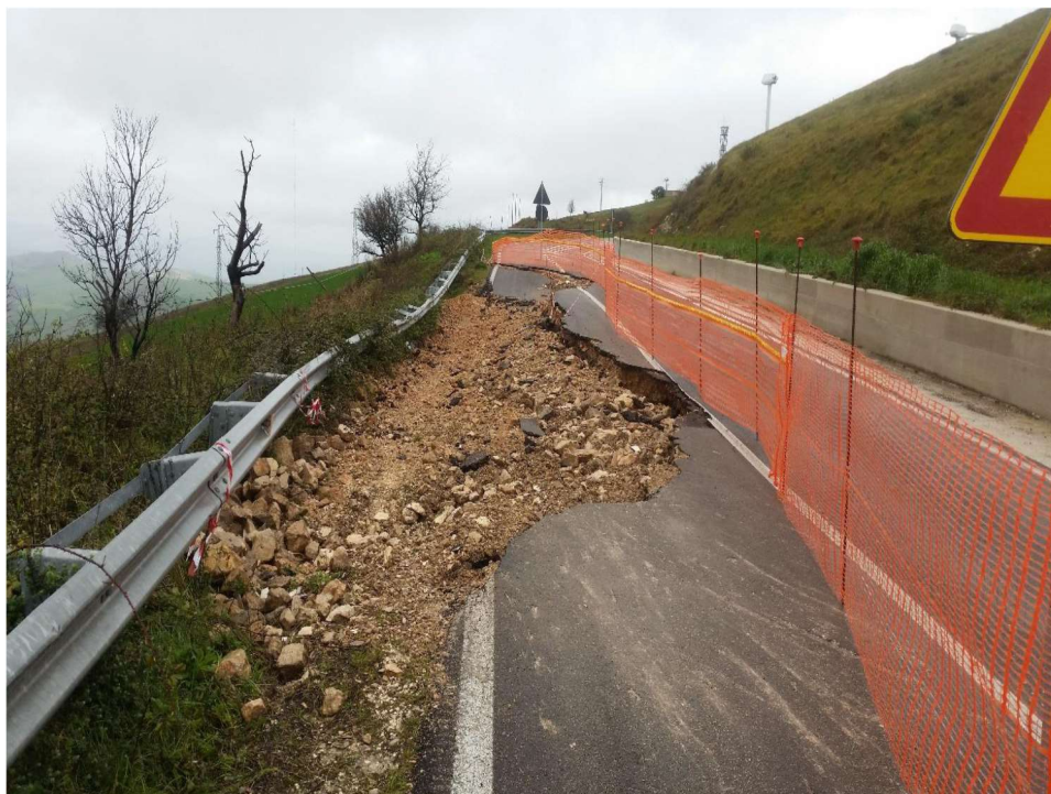
SP5 tratto di collegamento Pietramontecorvino – Castelnuovo. Cedimento di parte della carreggiata a seguito di un movimento franoso negli strati inferiori.
