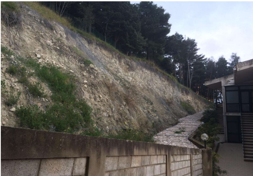
Frana. Aggravamento di situazioni preesistenti con distacco materiale roccioso da costone a ridosso delle palazzine del complesso 'Lori' Viale dell'Incoronata. Comune di Sant'Agata di Puglia.
