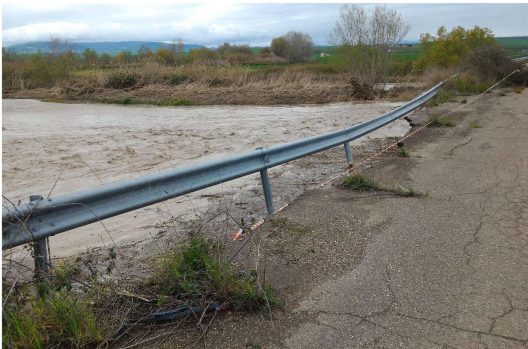
Torrente Carapelle , Ascoli Satriano. Aggravamento del cedimento del ponte di collegamento SP85 con la SP105 in località Sedia D'Orlando.
