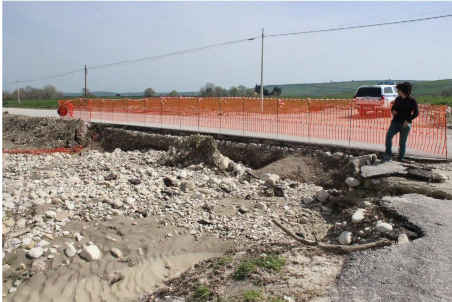
SP125 tratto di collegamento Troia-Celle di San Vito. Chiusura al traffico per invasione della sede stradale di materiale lapideo per esondazione del Torrente Celone.
