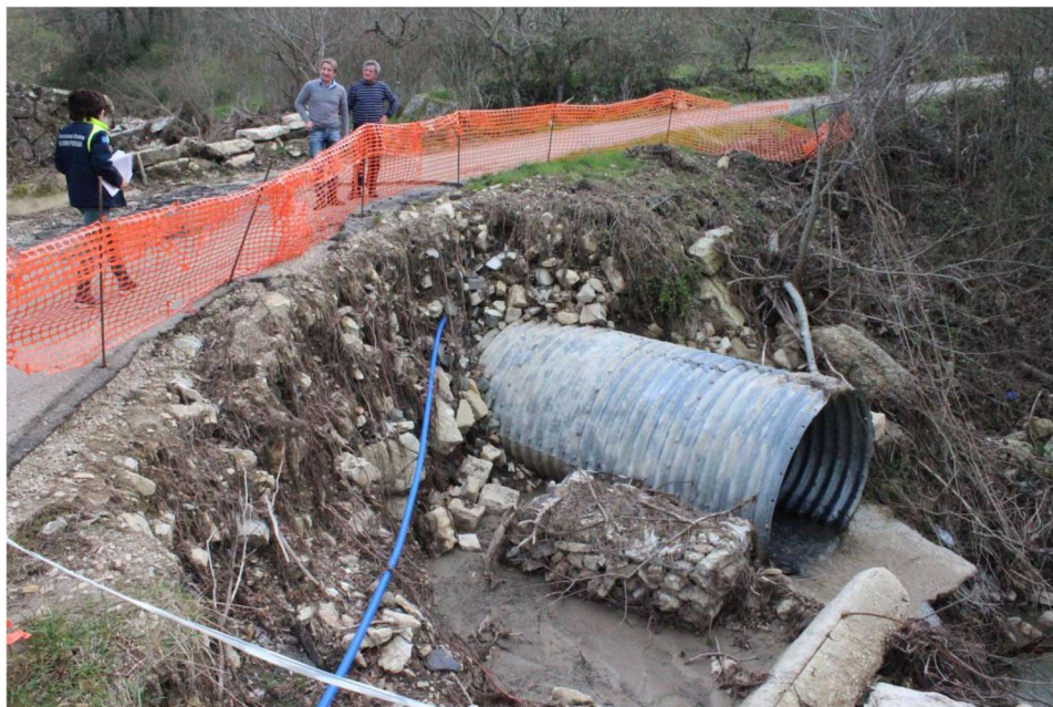
Torrente Fontanelle, affluente Celone. - C.da Le Cesi - Celle di San Vito. Tracimazione del torrente con erosione ed asportazione di parte della massicciata stradale - (unica via di collegamento con abitazioni rurali ed aziende agricole).
