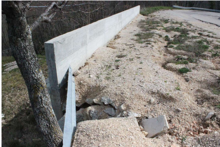
SP126 Celle di San Vito -bivio Celle di San Vito. Cedimento del muro di contenimento in corrispondenza di un breve tratto di strada non ultimato.
