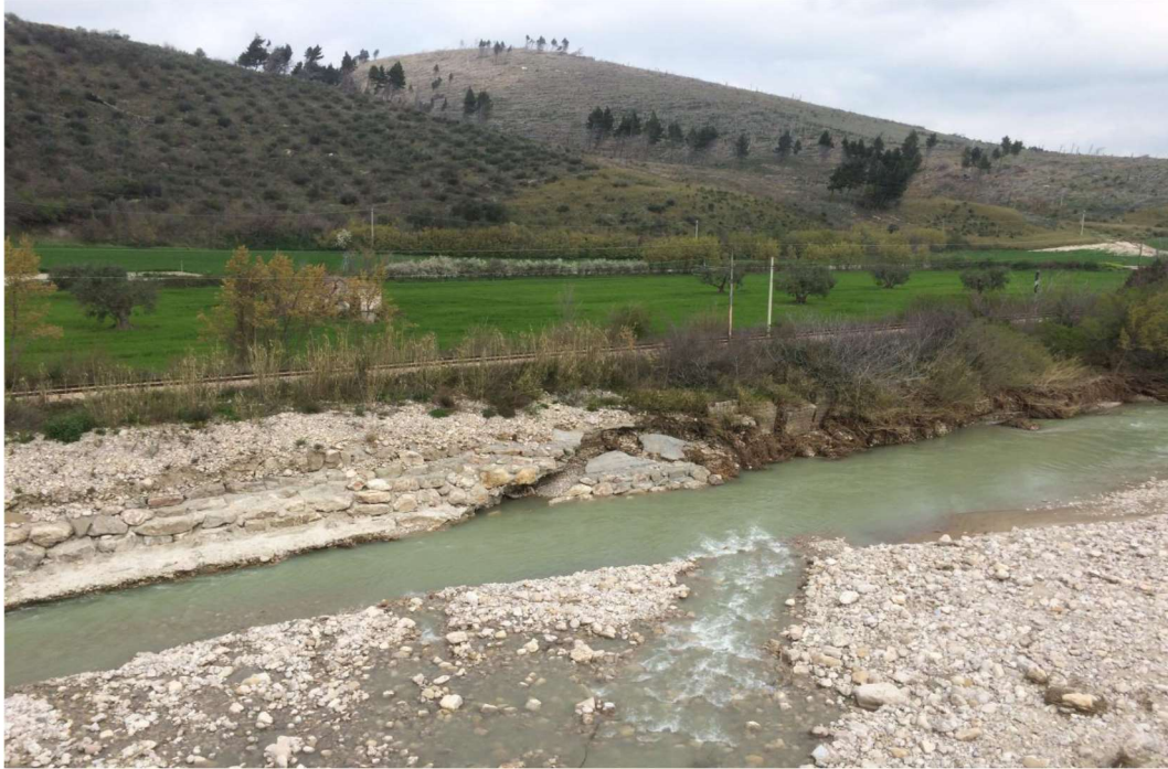
Torrente Cervaro sponda sinistra, Bovino. Erosione sotto linea ferroviaria.
