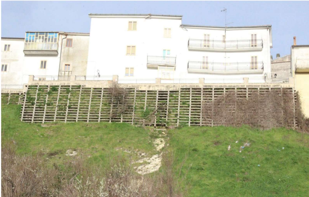
Erosione ed asportazione del terreno in corrispondenza del muro di protezione dell'abitato. Celle di San Vito - via Chiesa Vecchia.
