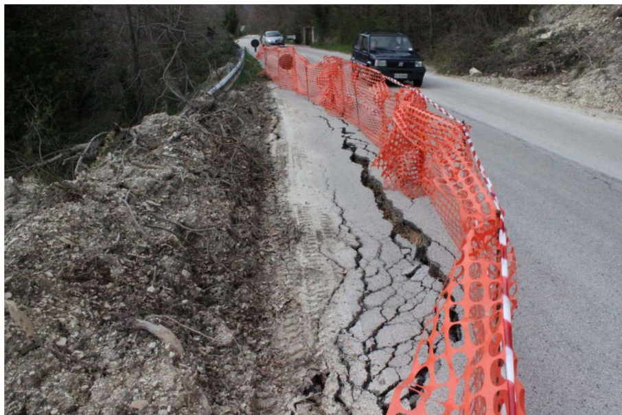
SP125 tratto Castelluccio-Faeto - Cedimento della sede stradale per effetto dello smottamento del versante con conseguente accumulo di fango e materiale detritico.
