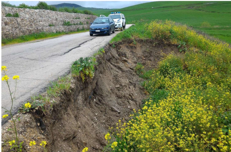
SP99 Comune di Rocchetta Sant'Antonio (località Pietralunga). Cedimento rilevato stradale a ridosso della condotta del metano.
